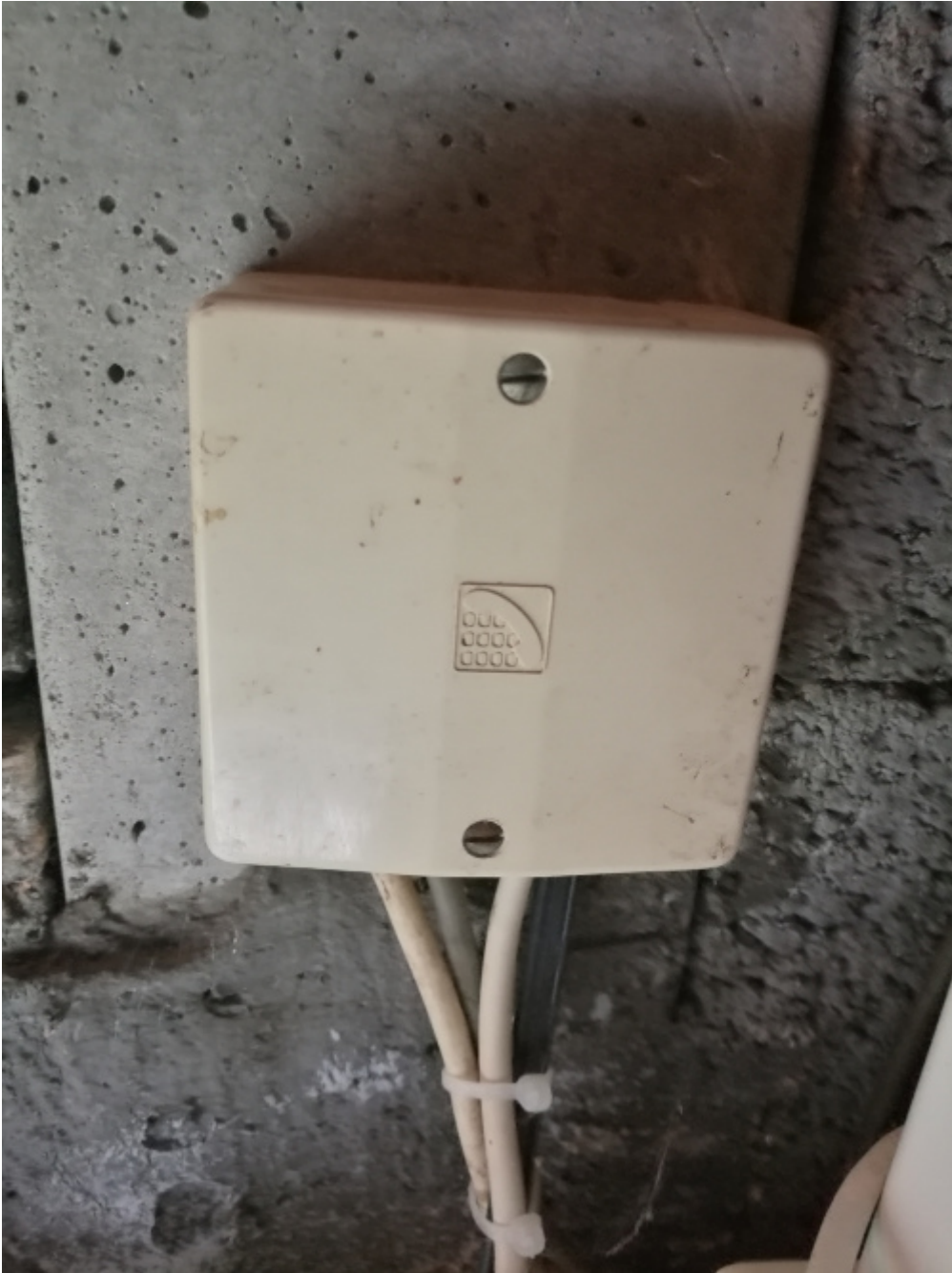
FIGURE 2.3. – Photo d'un boîtier de raccordement entre le câble téléphonique extérieur et les câbles téléphoniques intérieurs
